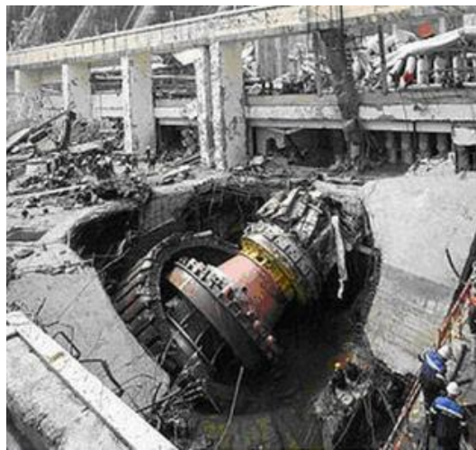
Рис. 5. Общий вид машинного зала Саяно-Шушунской ГЭС до аварии ( вверху ) и разрушенная турбина второго гидрогенератора ( внизу )
