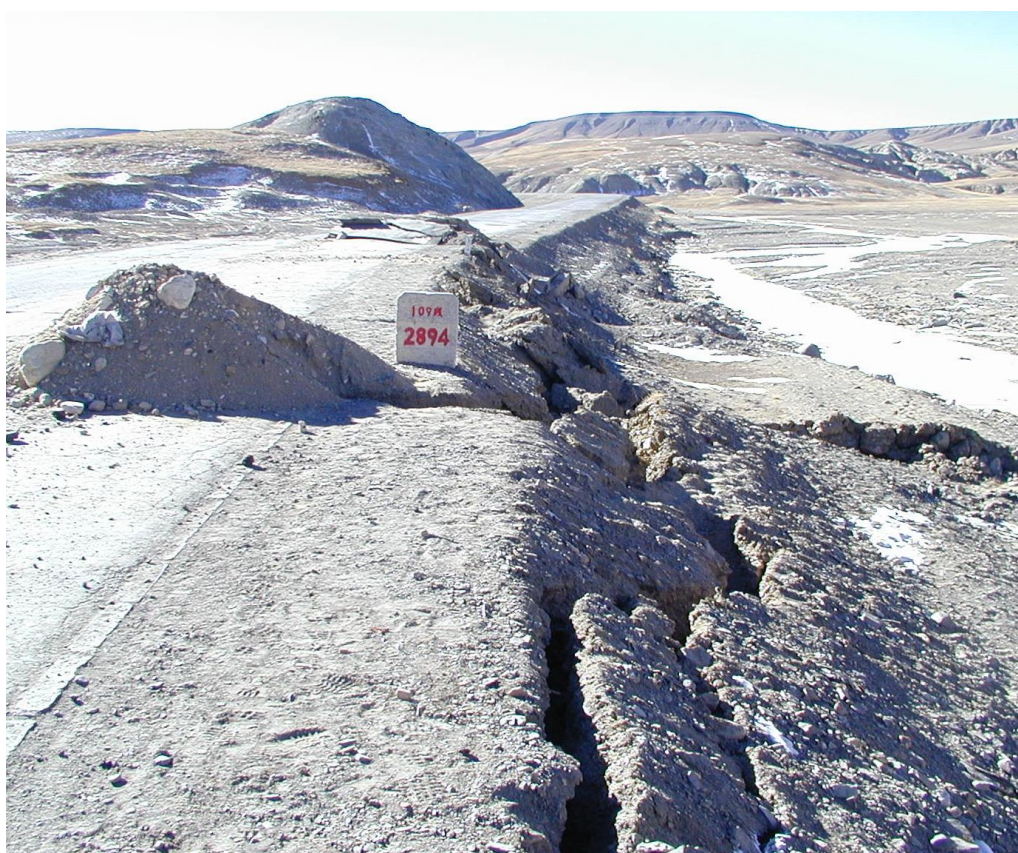
Рис. 13. Смещение автодороги сейсморазрывом Куньлуньского землетрясения 2001 г. (фото Ю. Шена)
