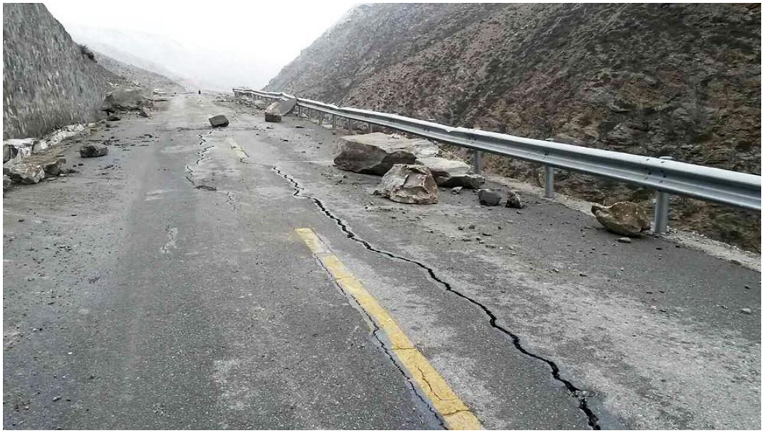
Рис. 29. Вибрационные трещины на дорожном покрытии в Высоких Гималаях.
