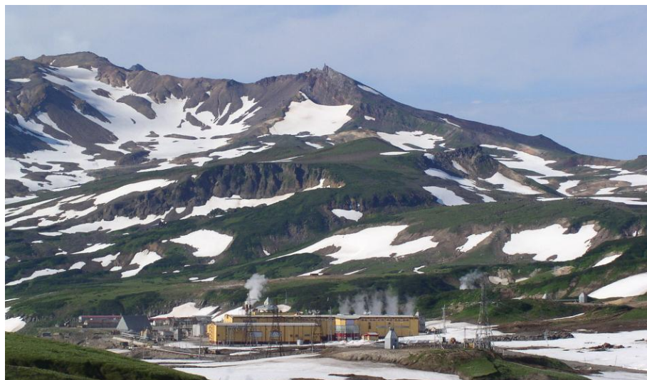
Мутновская ГеоЭС с установленной мощностью 50 МВт, на заднем плане влк. Мутновский-1 на расстоянии 6 км. Фото А.В. Кирюхина, август 2005 г.
